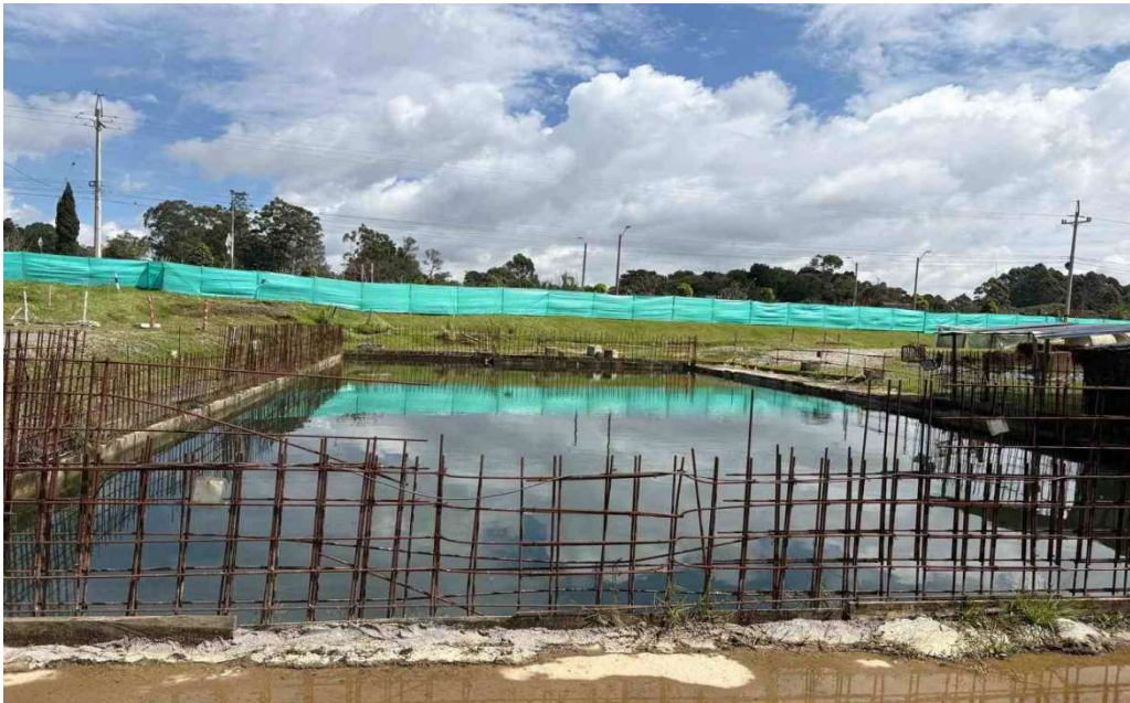
Figura 1. Registro fotográfico del 21 de abril de 2026, Edificio Pretratamiento de la PTAR Tranvía.
