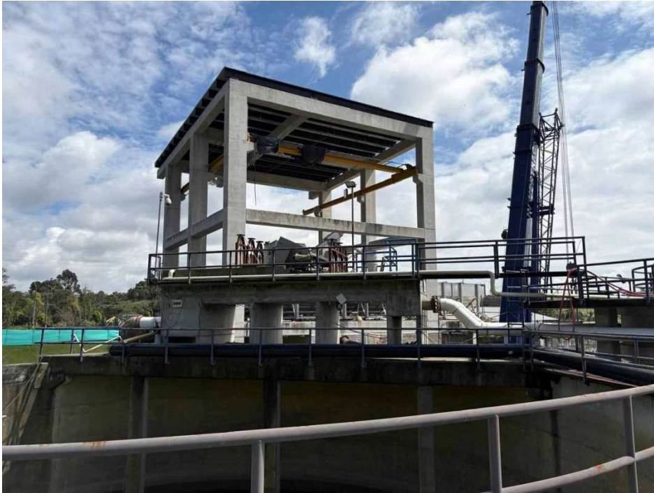
Figura 2. Registro fotográfico del 21 de abril de 2026, instalación de pretratamiento para la mejora de remoción de las aguas residuales a la PTAR Tranvía.
